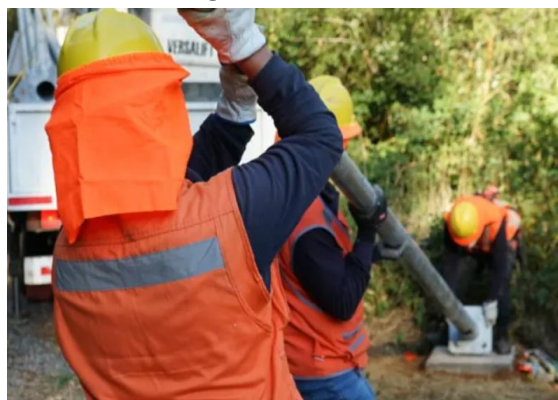
POSTACIÓN LUMINARIAS AUTÓNOMAS, DIVERSOS SECTORES RURALES.
